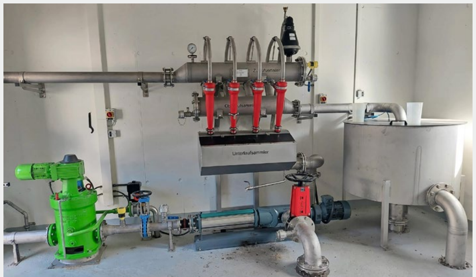
Fig. 2 Foto des Grobfilters (links, grün), der vier Hydrozyklone (rot) und des ÜSS-Vorlagebehälters (rechts).
